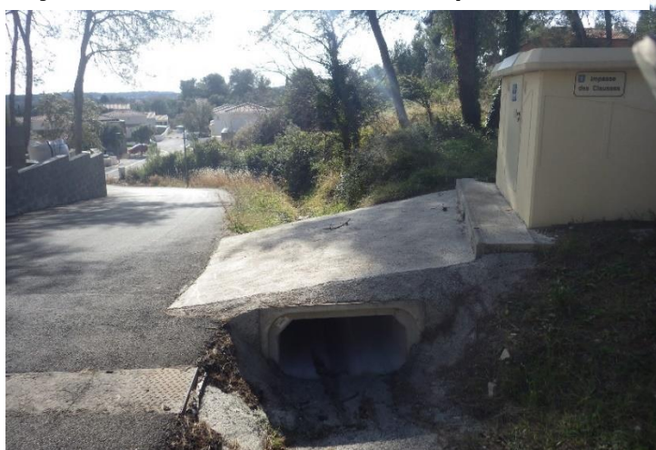
Rejet cunette béton dans cours d'eau imp des Clausses
