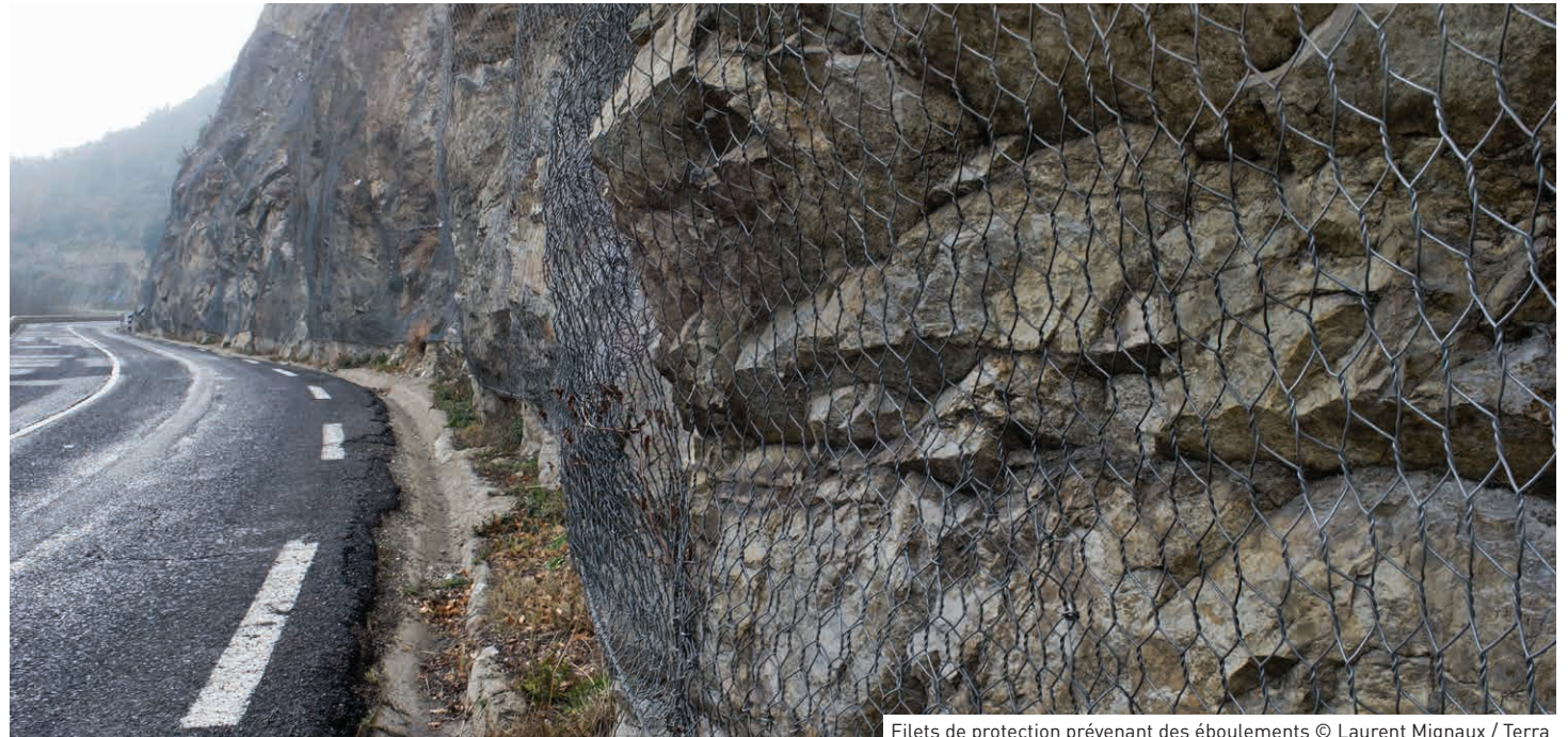
Filets de protection prévenant des éboulements © Laurent Mignaux / Terra
