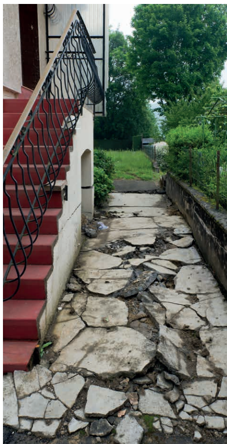
Affaissement de la voirie © Laurent Mignaux / Terra
