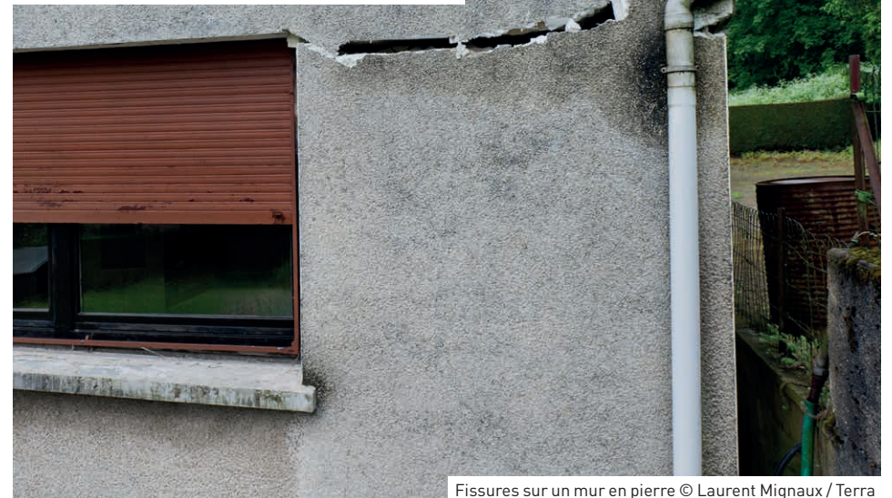
Fissures sur un mur en pierre © Laurent Mignaux / Terra
