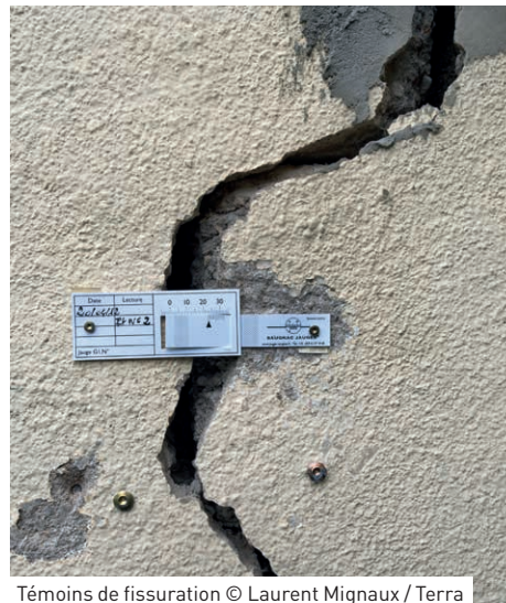
Témoins de fissuration © Laurent Mignaux / Terra
