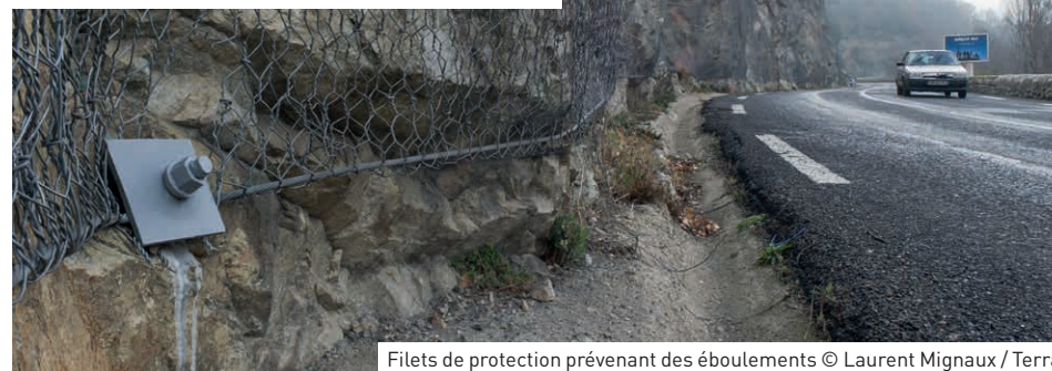
Filets de protection prévenant des éboulements © Laurent Mignaux / Terra
