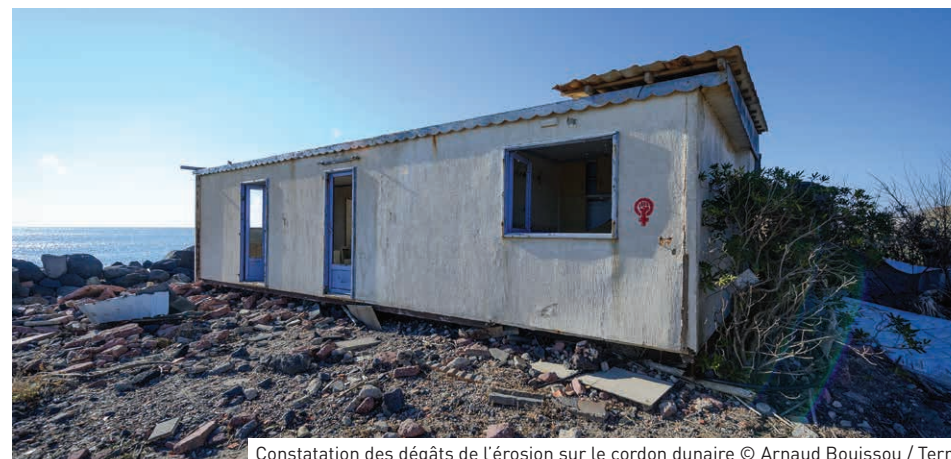
Constatation des dégâts de l'érosion sur le cordon dunaire © Arnaud Bouissou / Terra
